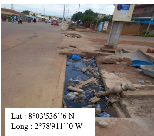
Photo 3a : Caniveau obstrué à cause de l'incivisme des populations au quartier Kamagaya
