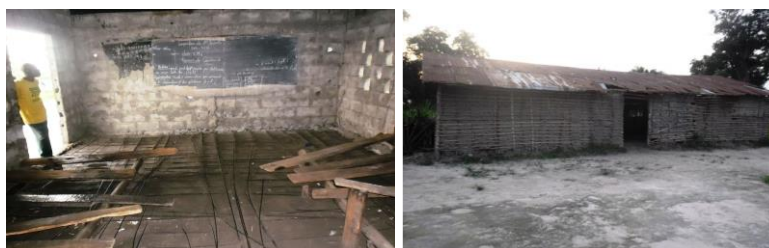
Photos 1 et 2 : Quelques état des bâtiments scolaires dans le département des Plateaux non réhabilités
