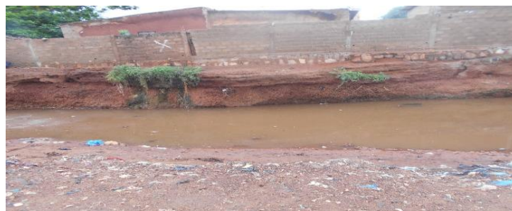
Photo 2 : Des constructions dans le lit du marigot Banconi
