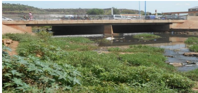
Photo 1: aperçu du Pont du marigot Woyowayanko à Djicoroni-Para obstrué d'ordures
